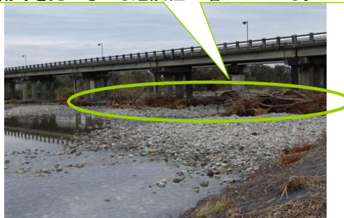
写真 3.46 洪水に伴う流木の橋脚への堆積状況 (蟹川橋)
