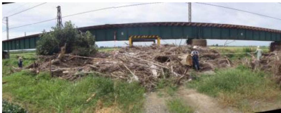
写真 3.48 JR 羽越本線阿賀野川橋梁への流木の堆積状況（平成 23 年 7 月出水）
