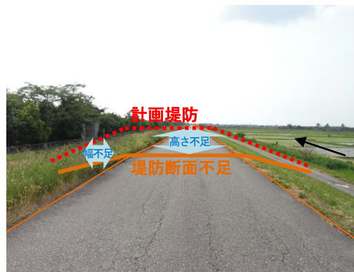
写真 3.28 堤防幅が不足している区間
