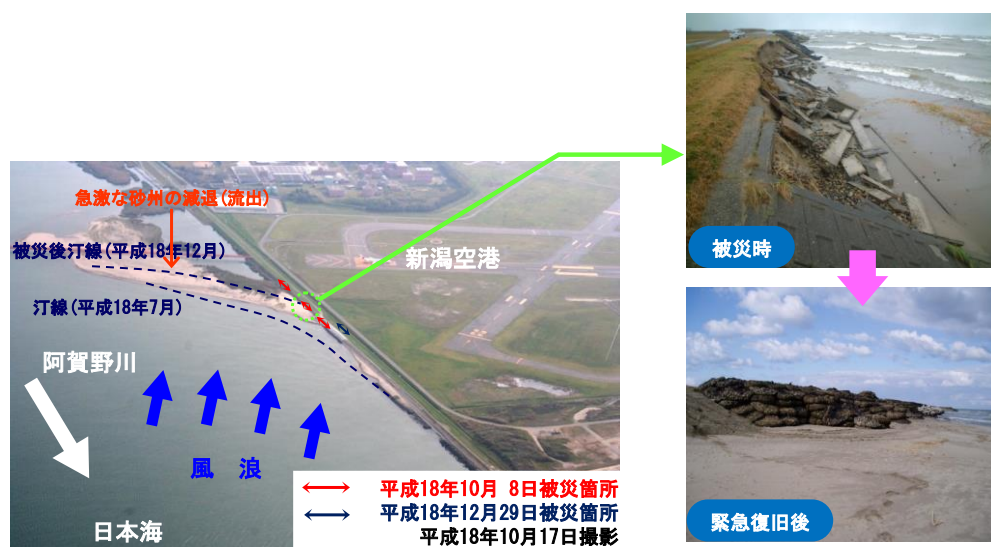
写真 3.52 波浪による河口部護岸の被災(平成18年10月, 12月)
