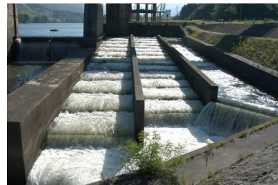
左岸に設置された魚道
