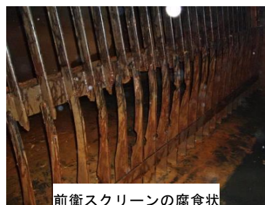
前衛スクリーンの腐食状
