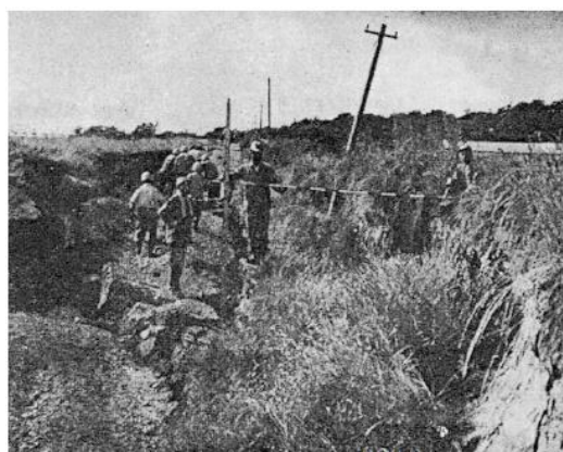
右岸堤防の陥没（新潟市名目所）
