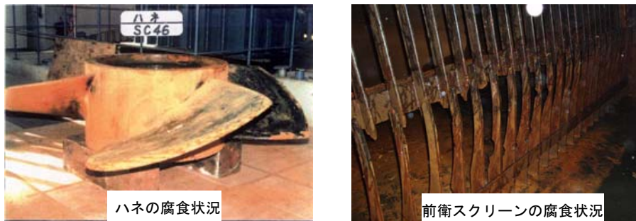
図 III-40 胡桃山排水機場設備の塩害による劣化
