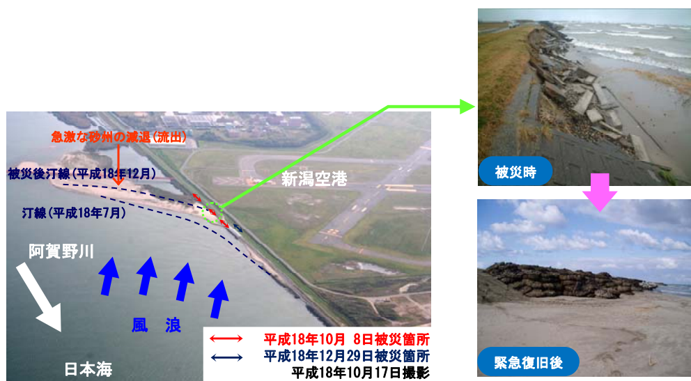
図 III-47 波浪による河口部護岸の被災（H18.10月，12月）
