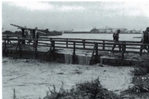
図 III-8 昭和 44 年(1969)8 月出水の早出川被災状況
