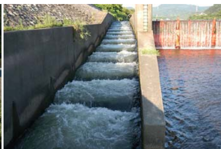
右岸に設置された魚道
