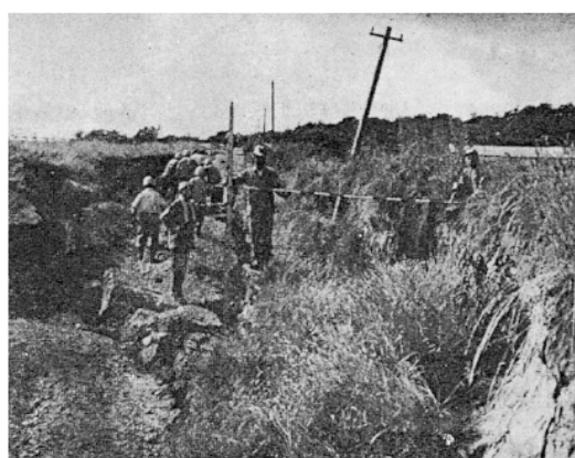
右岸堤防の陥没（新潟市名目所）
