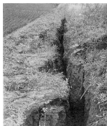
左岸 7k 堤防裏法尻の亀裂（新潟市細山）
