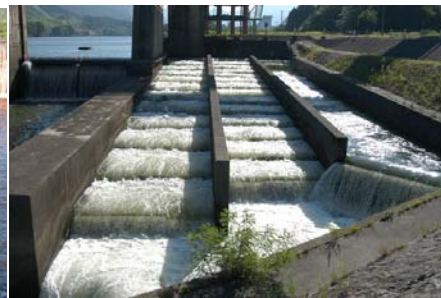
左岸に設置された魚道
