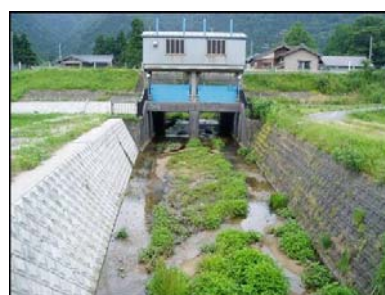
図 III-43 樋門の吐口に堆積した土砂
