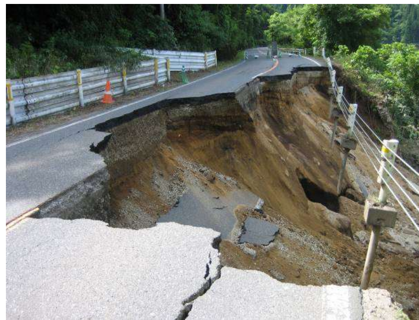
全面崩壊した国道 （国252号 柳津町飯谷地内）
