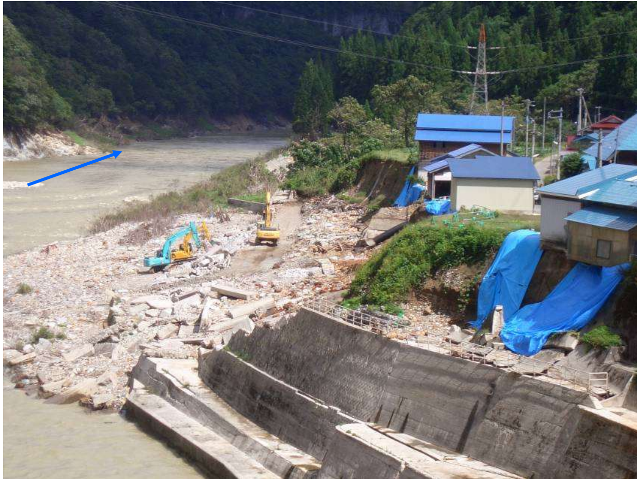
上田ダム直下流の護岸被災状況（応急復旧） （金山町上田地内）
