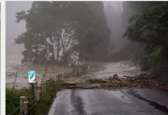
道路の冠水 上田～水沼間
