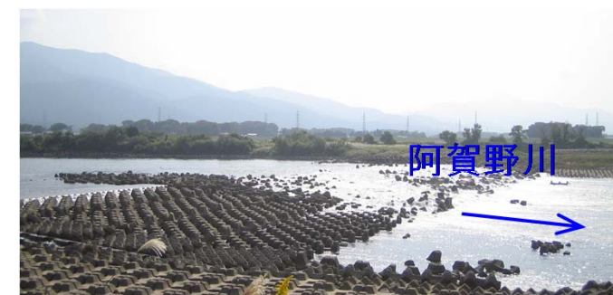
老朽化が進む渡場床固
