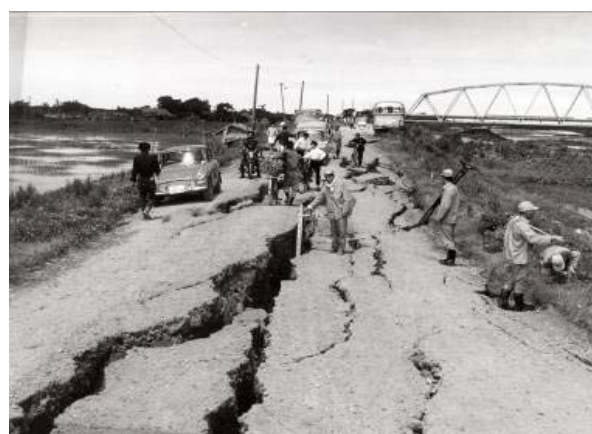
新潟地震（S39.6.16）による堤防被災状況
