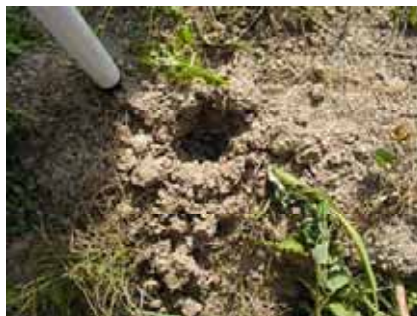
基盤漏水により発生したガマ跡
