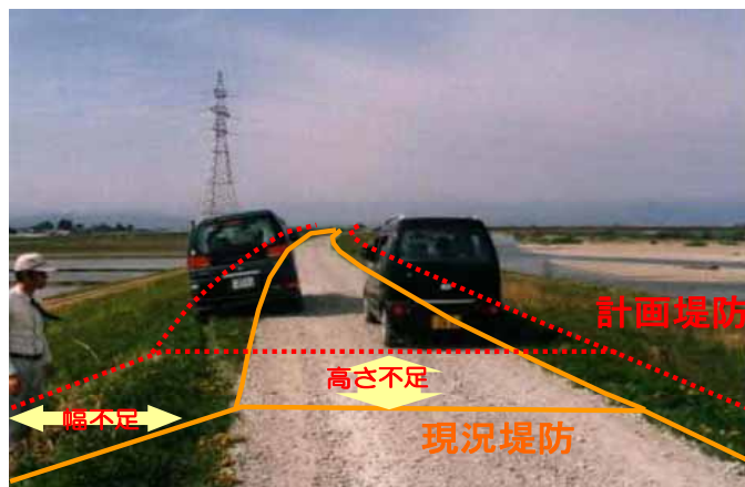
未完成断面の堤防（弱小堤防）
