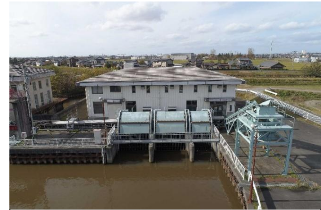
大沼排水機場
