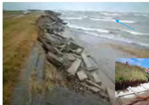
H18年護岸被災状況
