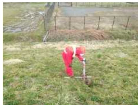
堤防法面の水みち
