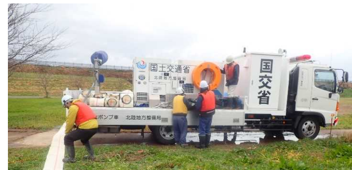
排水ホース配管
