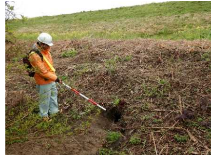
堤防法面損傷状況把握
