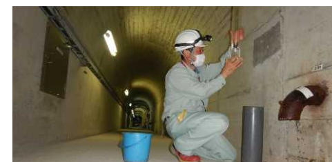
ダム監査廊内漏水観測
