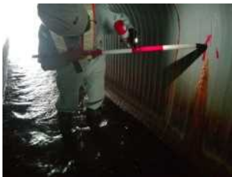
排水樋管等の函体内部クラック
