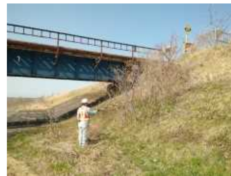
河岸の樹木繁茂
