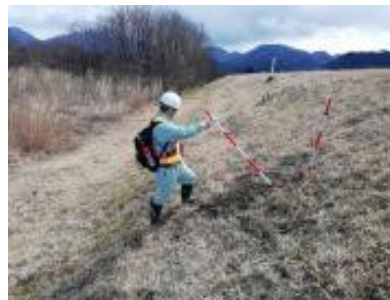
堤防法面損傷状況把握
