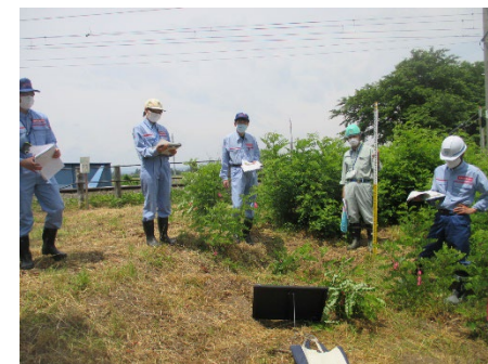
堤防法面のニセアカシア繁茂
