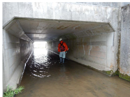
排水樋管等の函体内部クラック
