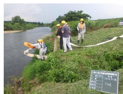
排水ホース配管
