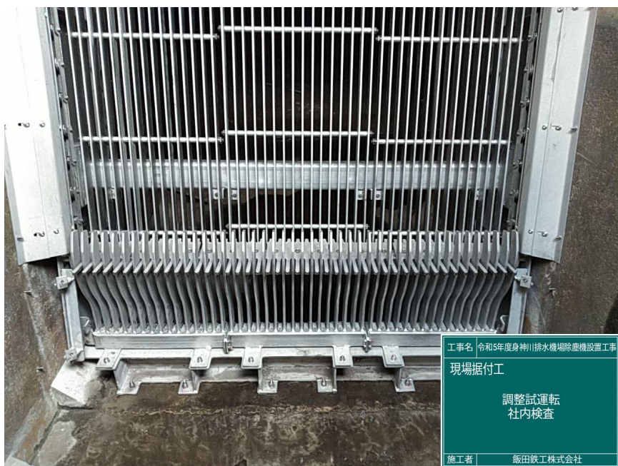
工事名 令和5年度身神川排水機場除塵機設置工事 現場据付工 調整試運転 社内検査 施工者 飯田致工株式会社
