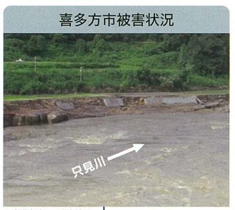
▲大道山区の護岸被災
