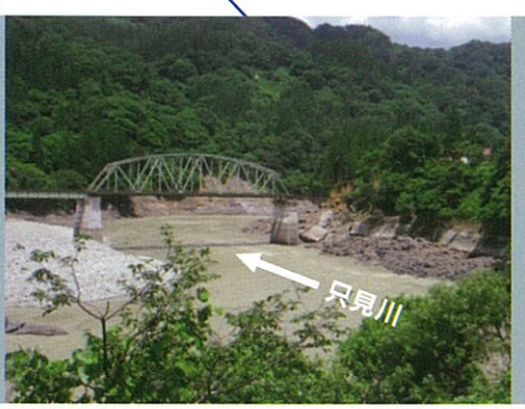
▲JR只見線 第五鉄橋の落橋
