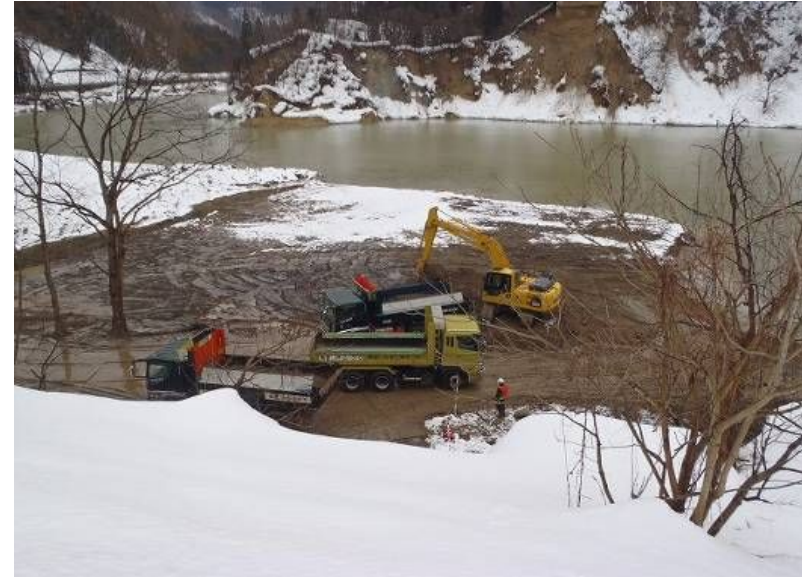
高倉地区土砂排除状況(平成23年度)
