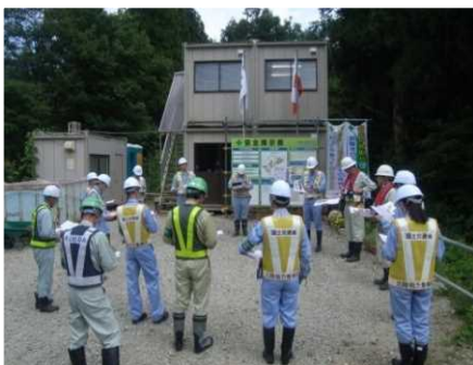
大源太川第1号砂防堰堤補強工事 パトロール前の工事説明
