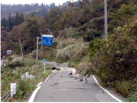
①新潟県中越地震の発生 (国道 291 号木籠付近 2004.10.23)
