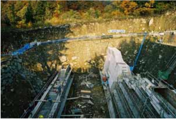
現在施工中の1号床固工。この状態からは完成形を想像し難いようで、モニターの皆さんからたくさんの質問が出されました。
