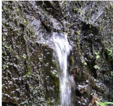
堰堤表面の漏水状況
