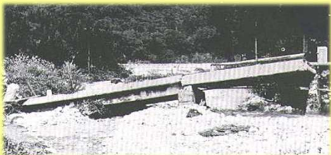
昭和23年アイオン台風の被災状況
