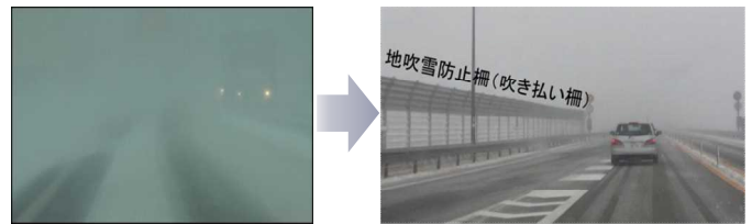
写真-1 地吹雪防止柵の設置事例
