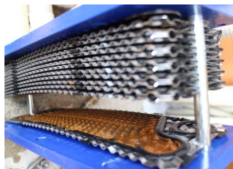
写真1 融雪水井戸流入後の酸化鉄付着の熱交換器
