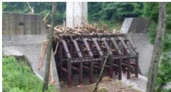
流木捕捉効果の高い砂防堰堤の設置
