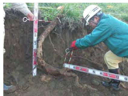
写真-3-1 堤防内部のクズ根
