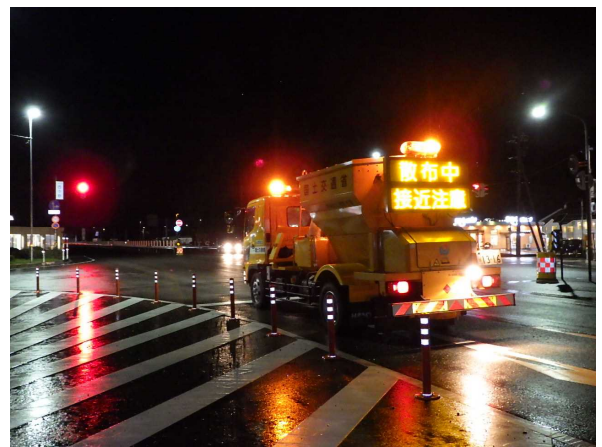
おやべ にしなかの 国道8号小矢部市西中野交差点における作業状況
