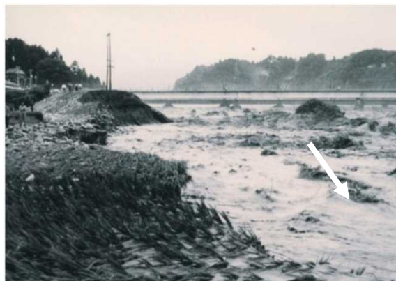
常願寺川 岩嶺寺地先の洗掘による破堤状況 (昭和44年8月11日洪水)
