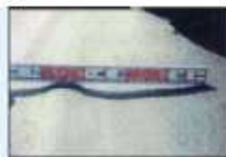
舗装のわだち掘れ
