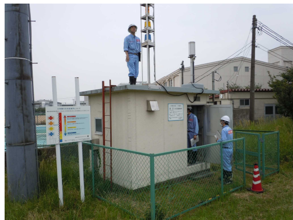
津沢水位／雨量観測所
