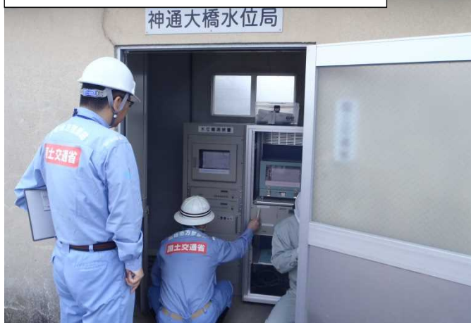
神通川 神通大橋水位・流量観測所点検状況
