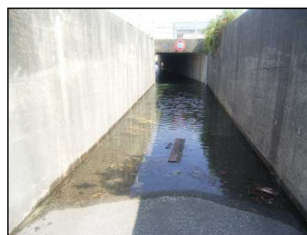
冠水した地下横断ボックスの事例
