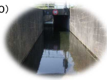
冠水した道路の事例
