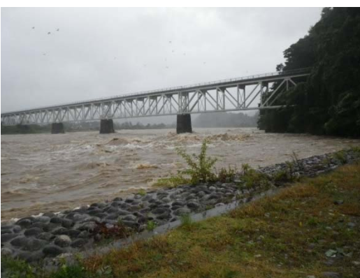
橋梁状況確認 高山線第一神通橋梁 （神通川右岸20.6k）富山市岩木
