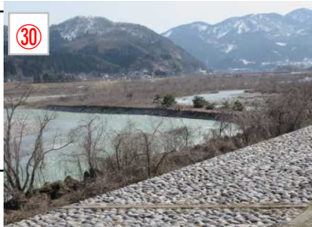
No.30 水衝・洗掘 護岸洗掘 L=150m 22.6k~22.6k+150m
