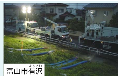
内水被害の状況（H16.10洪水）
