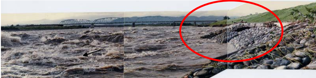
写真 2-25 S58.9 洪水(富山市成子の護岸欠壊堤脚洗掘状況)
