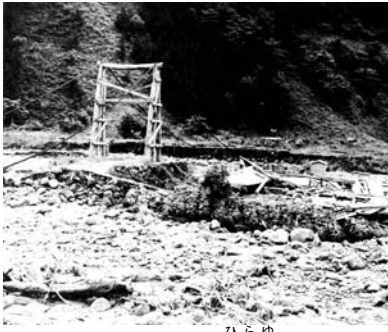
写真 2-23 S33.7 洪水(平湯川村上橋流失)
