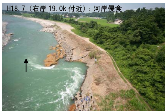
写真 3-1 洪水時の被害状況 (富山市塩)
