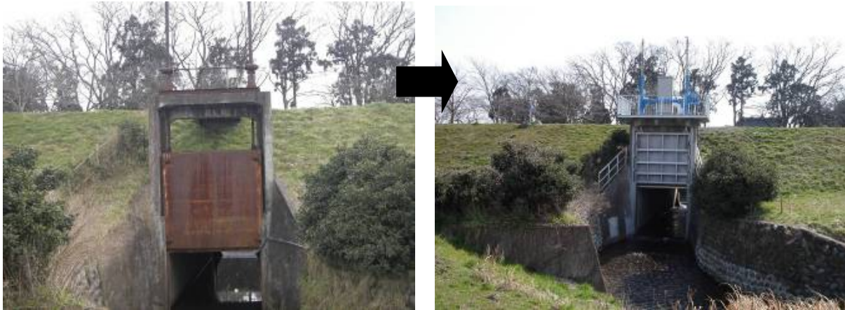
写真 3-11 老朽化した施設の補修例(松川舟通し水門 H19 実施)
