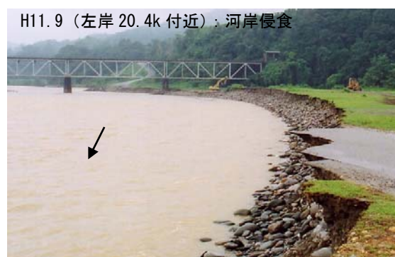
写真 3-2 洪水時の被害状況 (富山市八尾町西神通)
