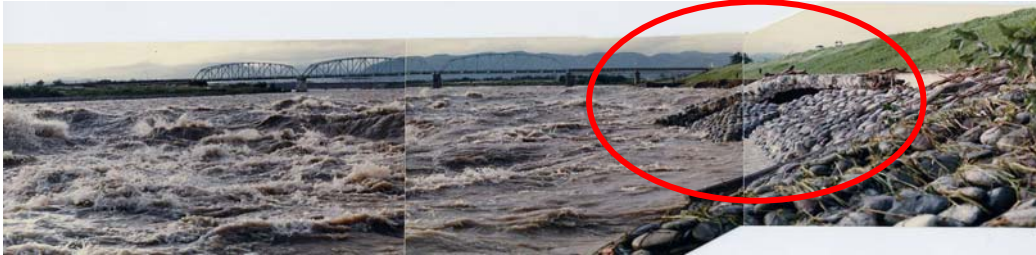
写真 2-24 S58.9 洪水(富山市成子の護岸欠壊堤脚洗掘状況)
