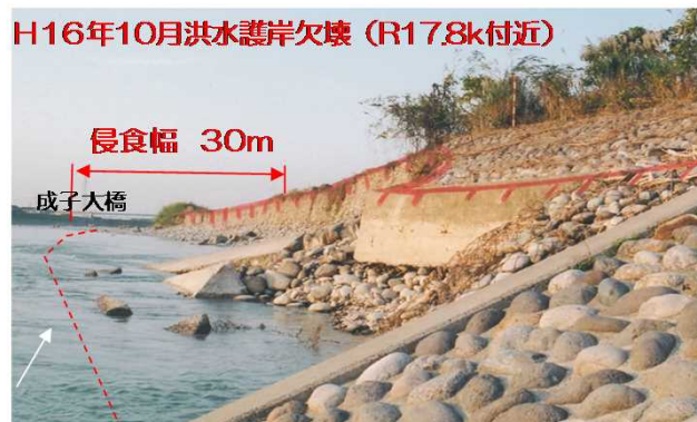
近年の被害状況 (H16.10洪水)
