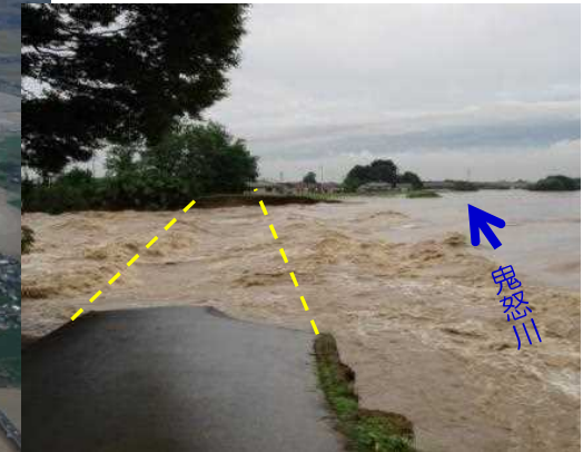
被災状況（拡大写真）
