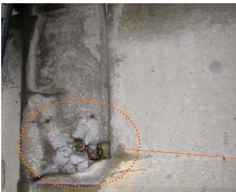
保護コンクリートの剥離状況
