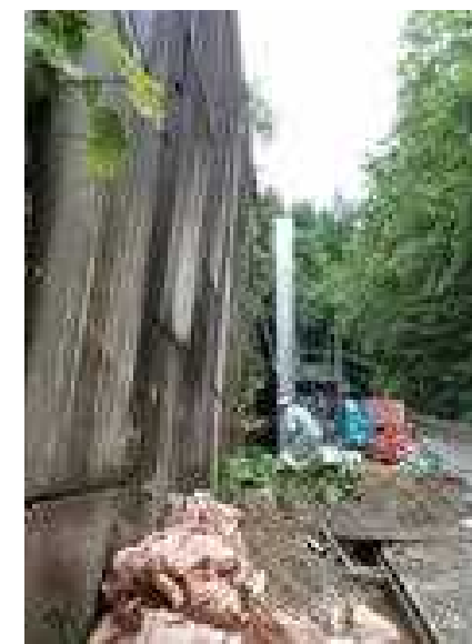
写真 壁面の傾斜の例
