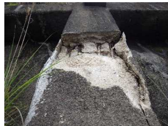
法砕工の老朽化損傷
