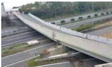
九州自動車道をまたぐ跨道橋の落橋 （県道小川嘉島線・府領第一橋）
