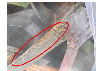
耐候性鋼材に層状の剥離
