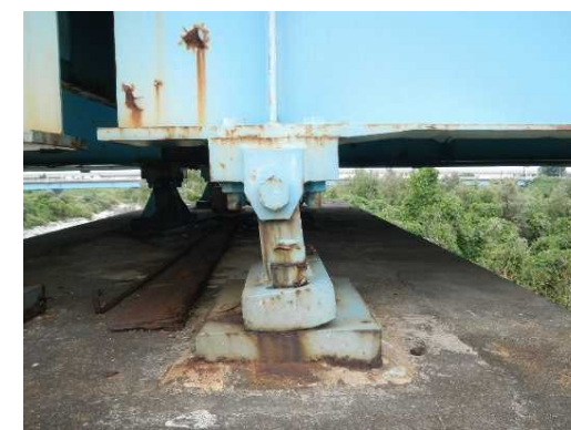
支承部の沈下・移動・傾斜状況
