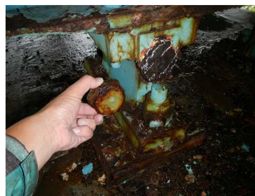
支承部の腐食状況
