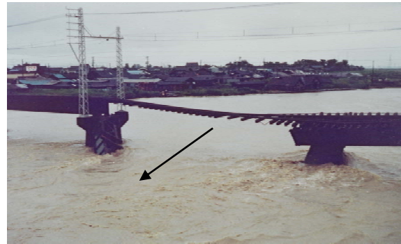
図 5-8 洪水時の洗掘による鉄道橋梁の落橋 (昭和 51 年 9 月洪水 Q_p \approx 2,650 \text{m}^3/\text{s} )
