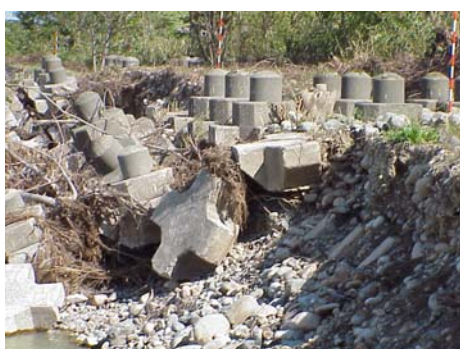
図 5-10 洗掘による被害
