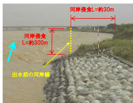
図 5-11 河岸の侵食状況（H11洪水）
