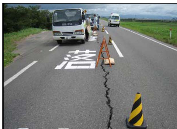
図 5-16 地震による堤防上面の亀裂
