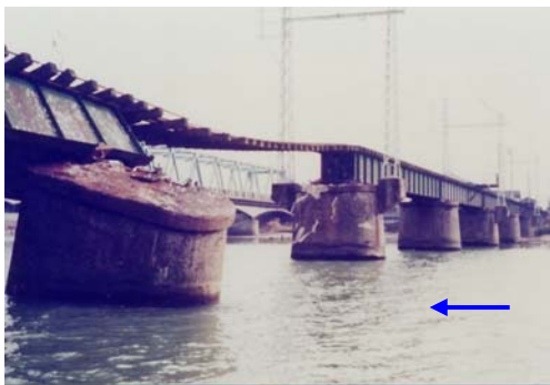
図3-3 昭和51年9月洪水 落橋した加越能鉄道橋
