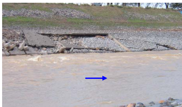
図3-6 平成16年10月洪水 堤防護岸欠壊及び根固流出
