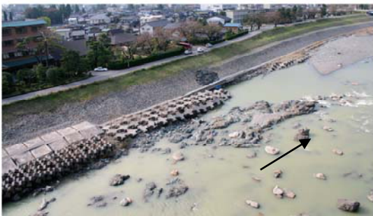
砺波市 庄川町金屋地先 洪水の激しい流れが水衝部に当たり、金屋地先では100mに渡って堤防護岸及び根固工が破壊された
