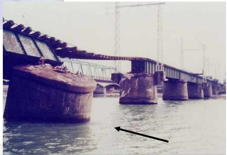
加越能鉄道落橋
