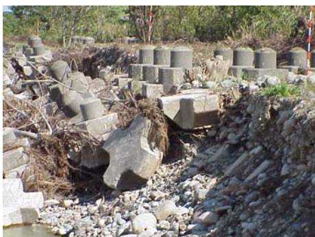
図 5-10 洗掘による被害
