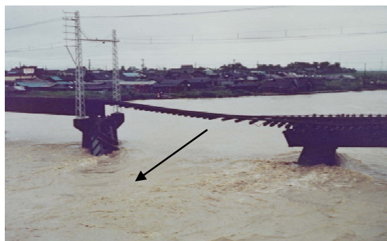
図 5-8 洪水時の洗掘による鉄道橋梁の落橋 (昭和 51 年 9 月洪水 Q_p \approx 2,650 \text{m}^3/\text{s} )
