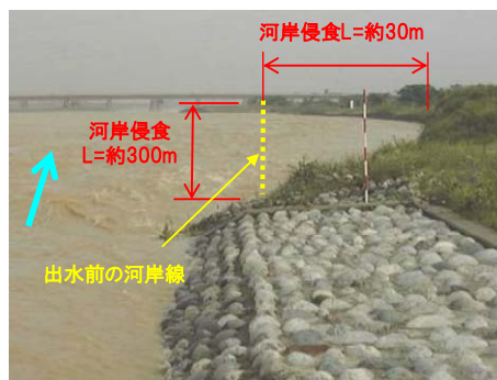
図 5-11 河岸の侵食状況（H11洪水）
