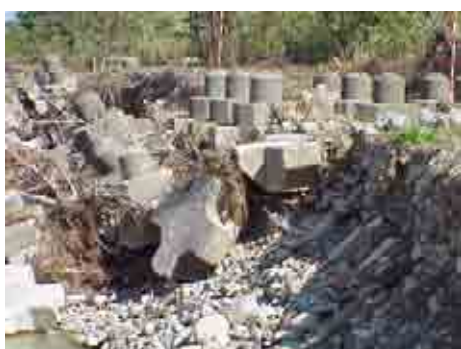
図 5-11 洗掘による被害
