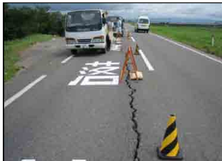
図 5-16 地震による堤防上面の亀裂
