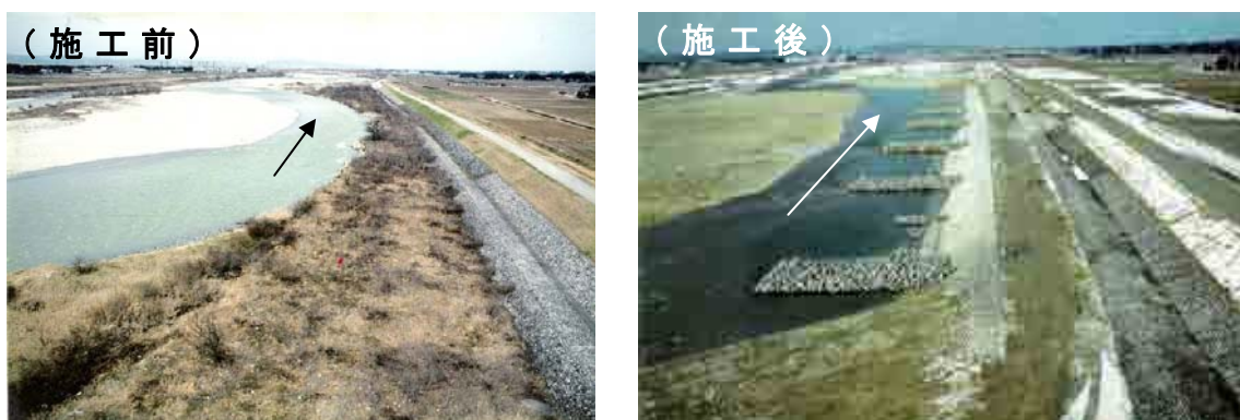
図 5-19 多自然川づくりの施工事例 ～ 自然石を用いた水制で新たに淵を創出する～ 左岸坂東地区右岸 (19.0k～19.3k)
