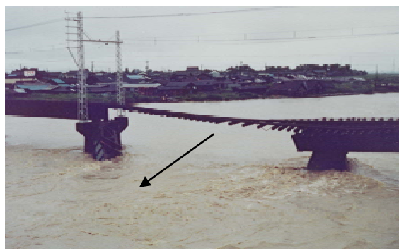
図 5-7 洪水時の洗掘による鉄道橋梁の落橋 (昭和 51 年 9 月洪水 Q_p \approx 2,650 \text{m}^3/\text{s} )
