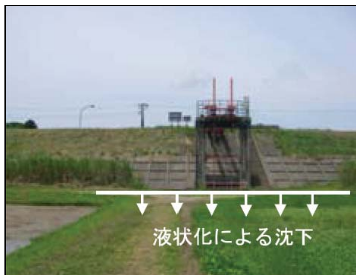
図 5-15 液状化による河川管理施設の沈下
