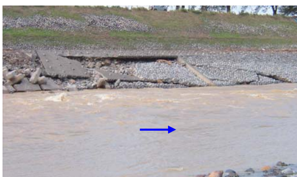
図3-6 平成16年10月洪水 堤防護岸欠壊及び根固流出
