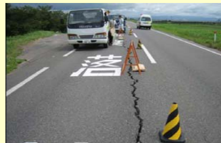
地震による堤防上面の亀裂
