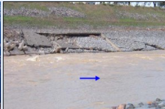
H16洪水の護岸被災
