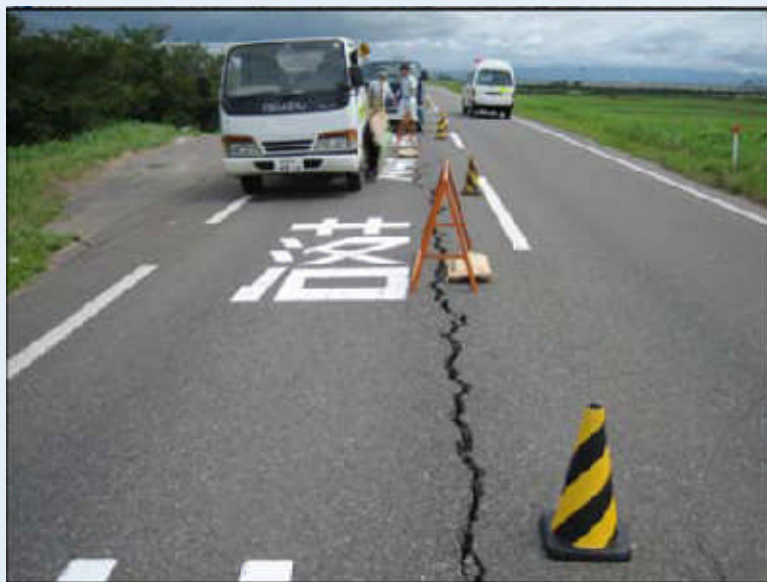
■ 中越沖地震による堤防上面亀裂（信濃川大河津分水路）
